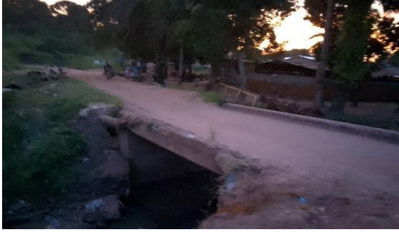
Photo 4. Etat de l'ouvrage de franchissement sur le marigot au passage de l'avenue A. MBEMBA
